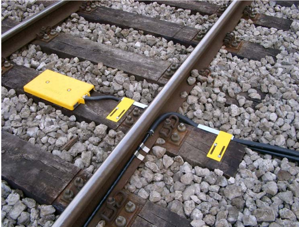
balise montée dans la voie
